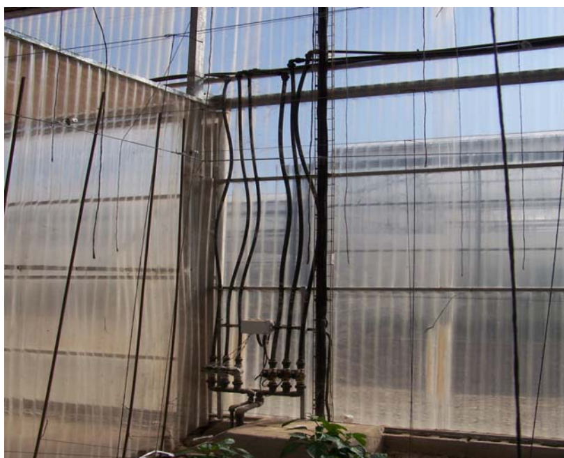
Foto 4: Sistema de alimentación del humidificador en el invernadero.
