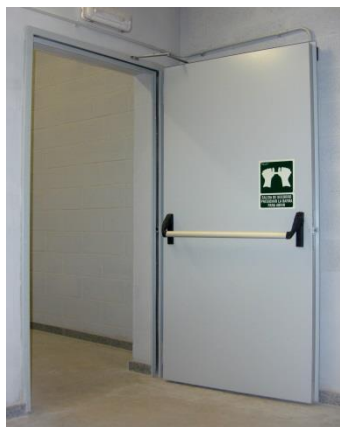
FIG. 16. PUERTA CORTAFUEGOS (ERRECE)
