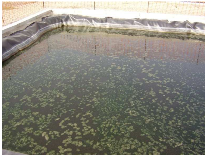
Foto IV.7.- Balsa de efluente depurado tras su paso por los humedales artificiales. Con un crecimiento de algas, las cuales permiten una mayor depuración.
