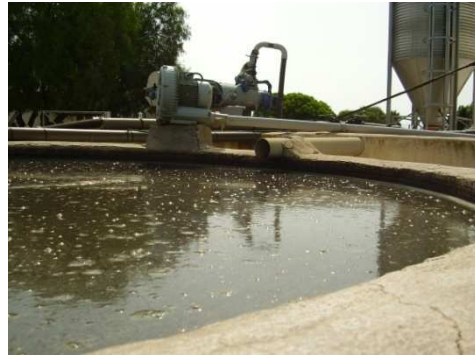
Foto IV.4.- Depósito de decantación de purín.
