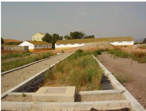
Foto IV.5.- Humedal de flujo horizontal subsuperficial. Concretamente el 6.
