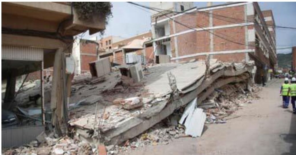
Foto real del edificio colapsado en Calle Infante Juan Manuel.
