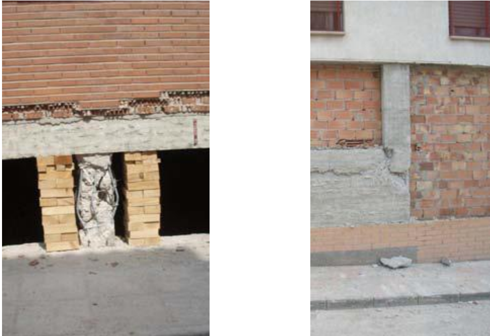
Dos tipos de pilares cortos dañados en edificios de Lorca. figura 1
