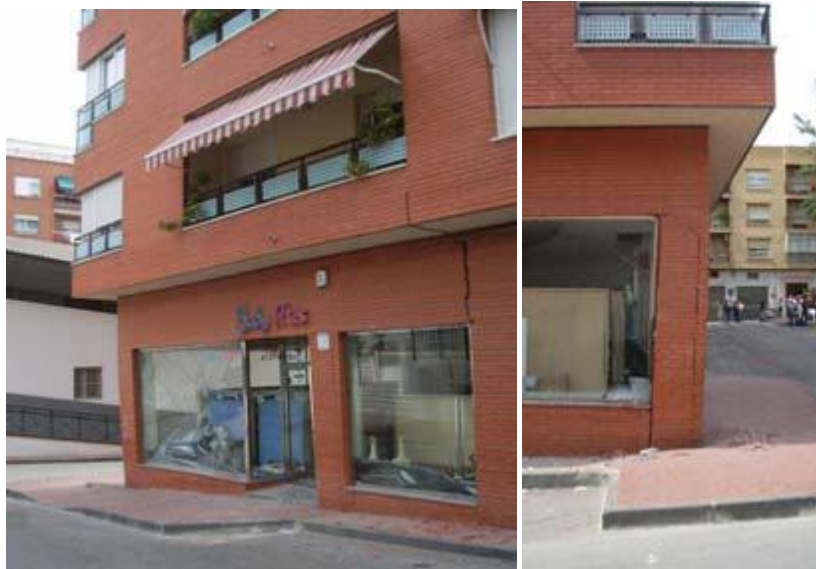
Torsión por el efecto de rigidización de un edificio de esquina con los muros medianeros con grandes deformaciones permanentes en el pilar de la esquina más alejada del centro de rotación.
