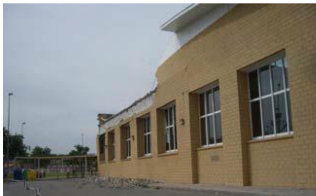
Desprendimiento de un parapeto de hormigón sin armadura
