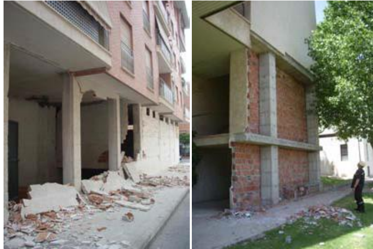
Daños en los cerramientos de las plantas bajas de un edificio con locales comerciales de gran esbeltez (izquierda) y en el hospital Rafael Méndez. (Derecha).
