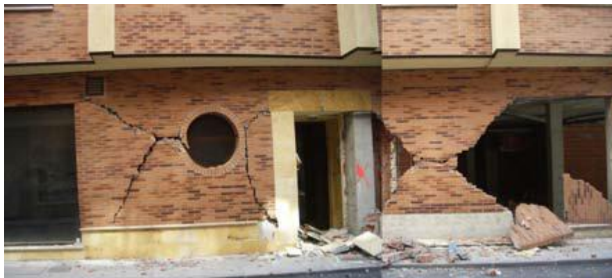
Daños en el cerramiento no estructural de la planta baja de un edificio. El cerramiento ha resistido los esfuerzos horizontales de la estructura, pero ha fallado por cortante (grietas en forma de cruz de San Andres.)
