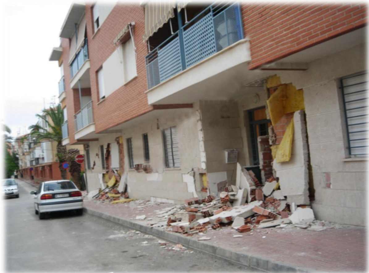
Planta baja dañada en un edificio que se ve claramente las irregularidades en altura.
