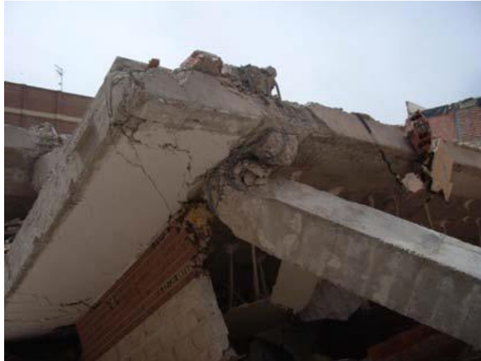
Detalle de la unión entre pilar-forjado del edificio colapsado.
