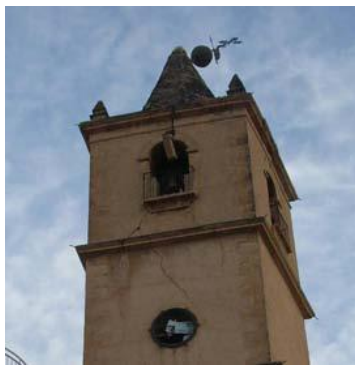
Daños por cortante en forma de aspa en la torre de la iglesia del paso azul.
