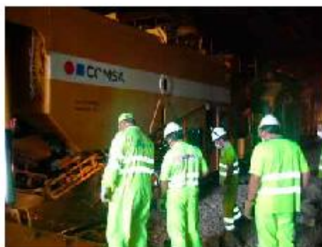
Figura 5. Riesgo de arrollamiento por presencia de maquinaria ferroviaria
