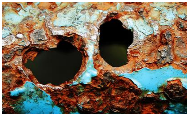
Figura 1.1.3.2.4. Desgaste por corrosión.
