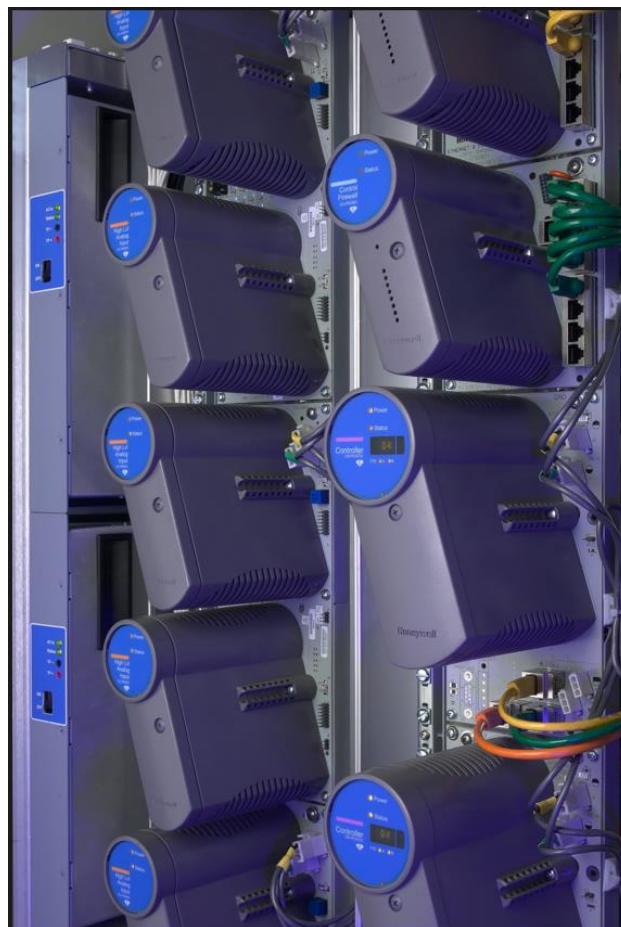
Figura 8. Cuadro de control C300
