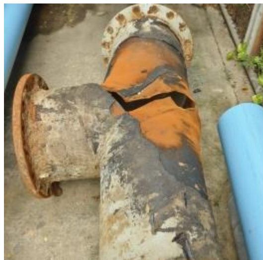
Figura 1.2. Rotura de una tubería por efecto del golpe de ariete
