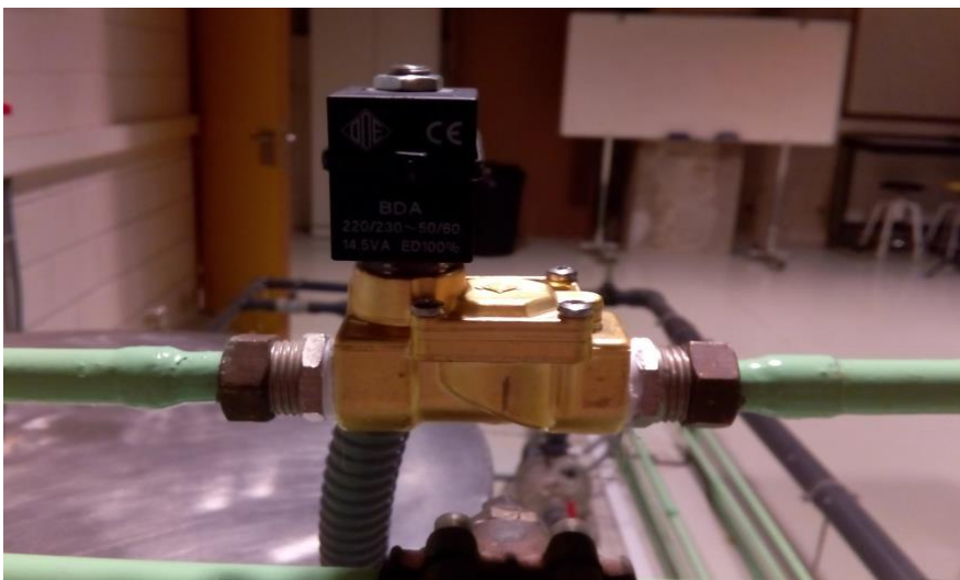
Figura 4.9. Electroválvula de la instalación
