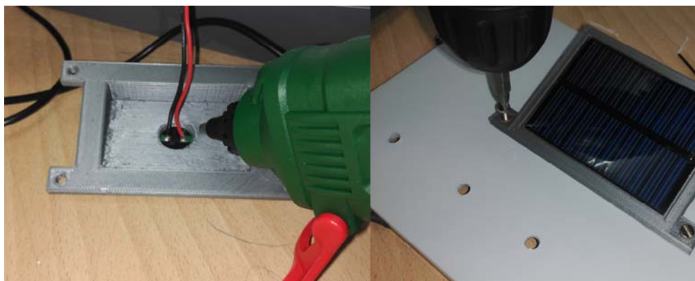
Figura 29. Implementación del panel solar
