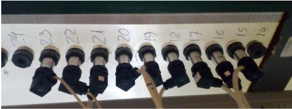
Figura 38. Distribución de sensores de presión en el eje central de la solera del cuenco de amortiguación.
