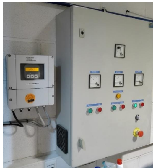
Figura 30. Panel de bombeo y lector del caudalímetro.
