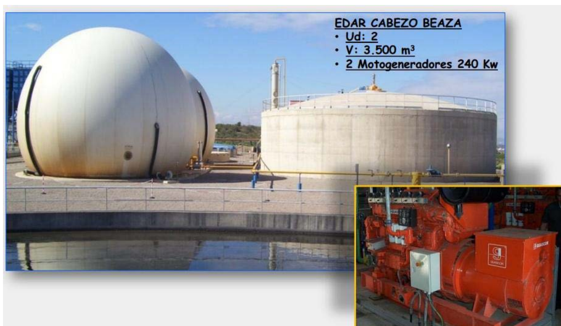
Figura 4.3. Biogás y cogeneración en EDAR Cabezo Beaza.
