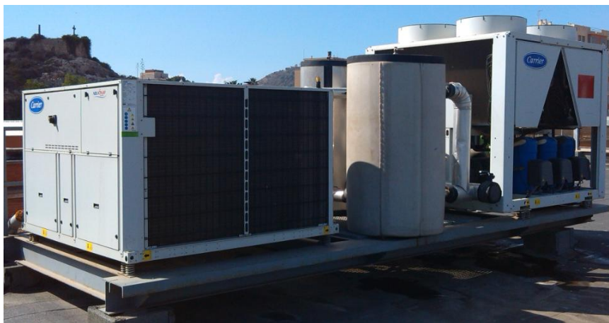
Ilustración 38: Planta enfriadora en la cubierta del edificio
