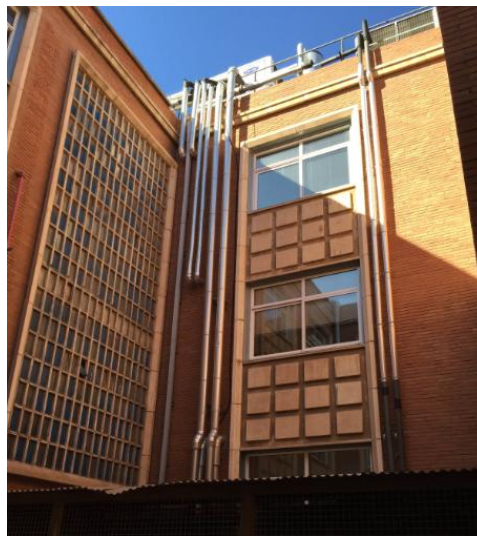
Ilustración 43: Tuberías Subsistema Secundario
