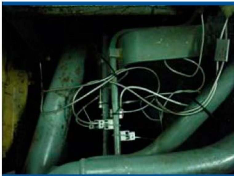
Sensores (detalle del detector de caudal)
