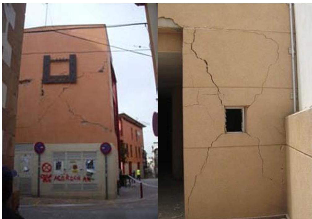
Figura 29: daños en cerramientos en forma de aspa debidos al cortante.
