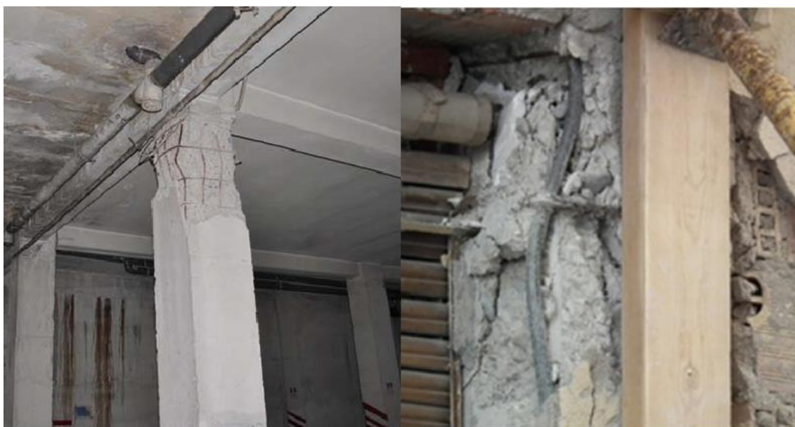
Figura 28: Daño en pilares debidos a deficiencias en la armadura.
