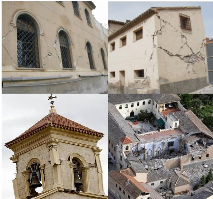
Figura 12: Daños en el Convento de Las Clarisas.
