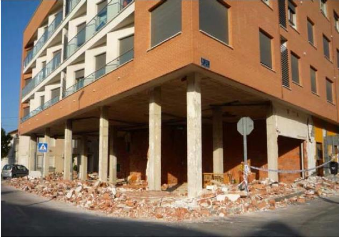
Figura 26: Pérdida de los cerramientos en un edificio de Lorca debido al efecto de planta blanda
