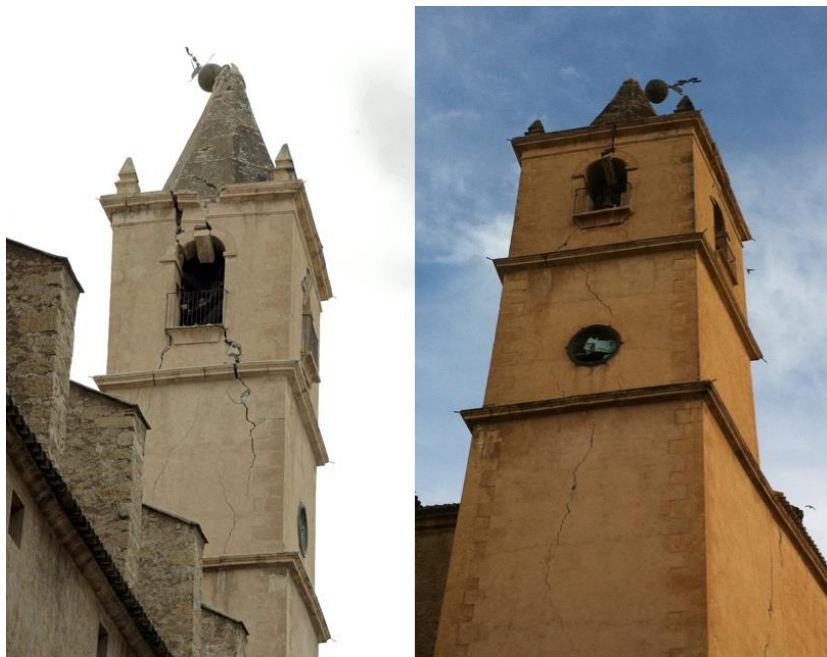
Figura 13: Torre dañada de la Iglesia de San Francisco.
