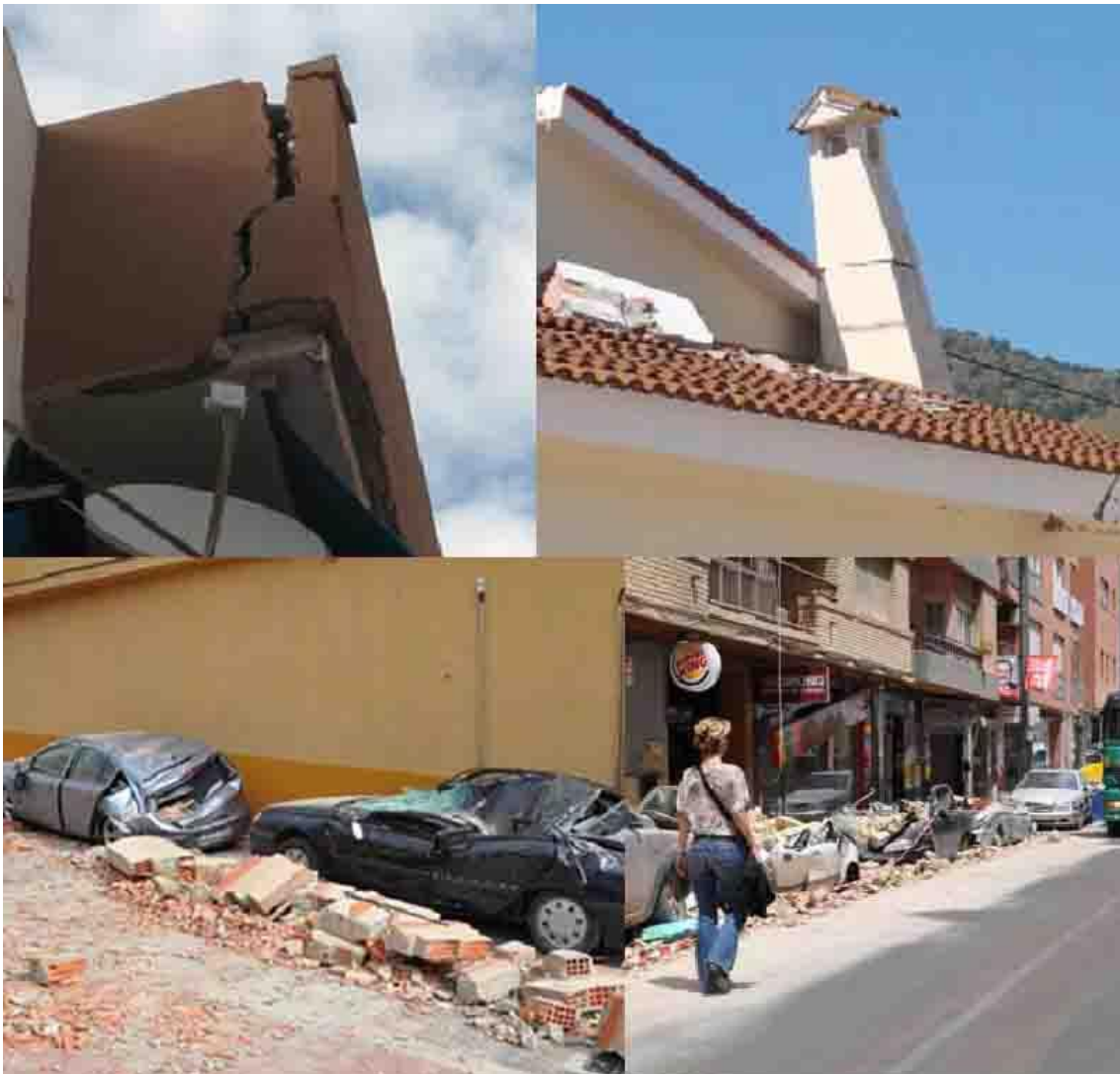
Figura 30: Daños por desprendimiento de elementos no estructurales.
