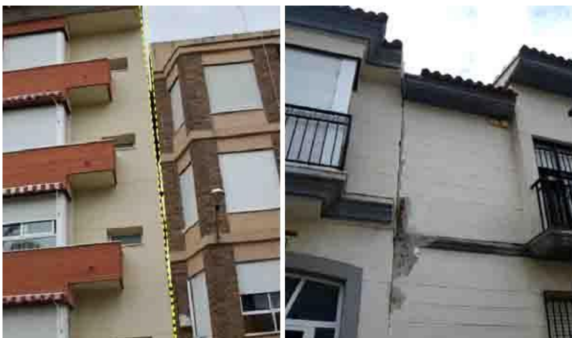
Figura 31: Daño por golpeteo observado en Lorca tras el sismo.
