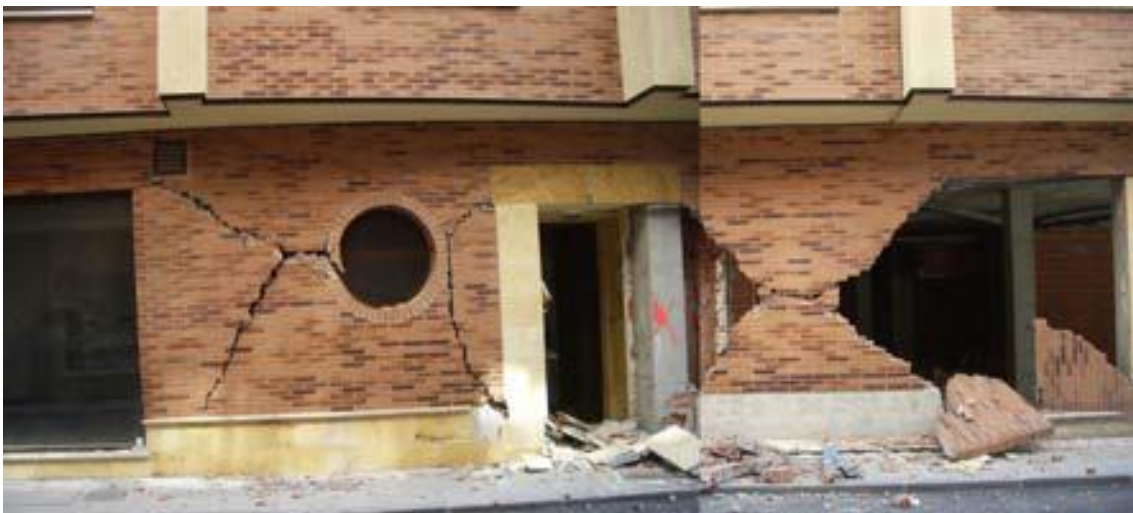
Figura 27: Daños en el cerramiento en una planta blanda.
