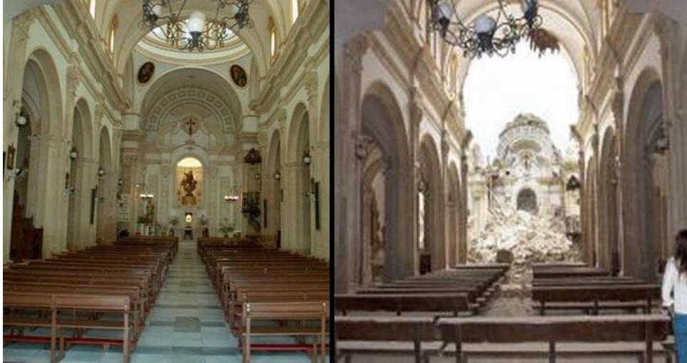
Figura 9: Interior de la Iglesia de Santiago antes y después del terremoto de Lorca del 2011.
