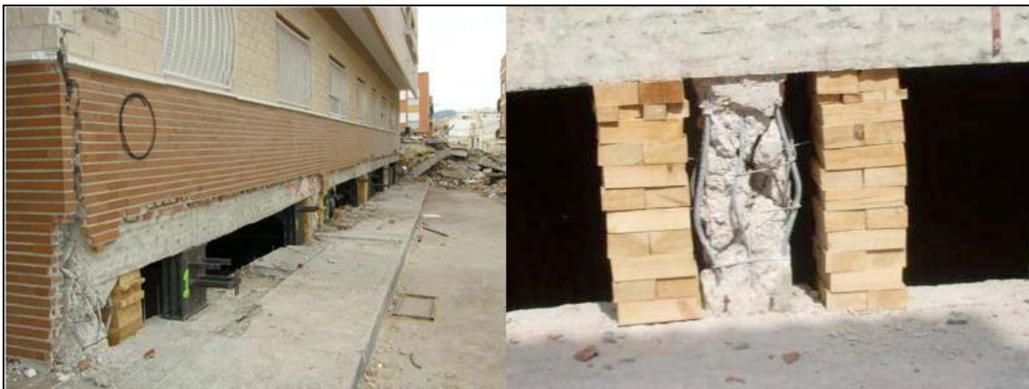
Figura 24: Daño en pilares cortos de edificio colindante.
