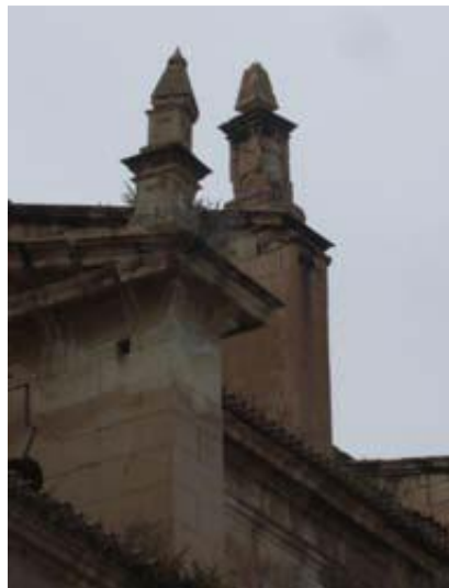
Figura 18: Pináculos dañados en la Colegiata de San Patricio.
