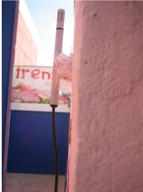
Figura 27. Situación de las sondas de temperatura exterior.
