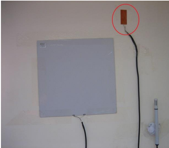
Figura 5. Sensor de temperatura superficial interior.
