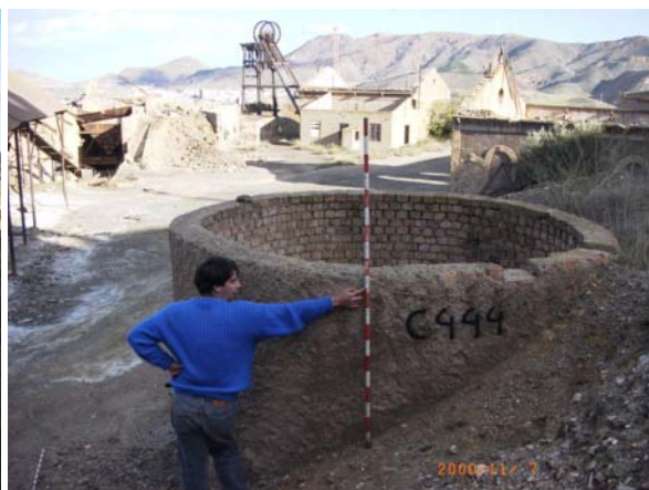
Foto 2.4. Pozo 50-C444. El brocal no protege en uno de sus puntos. Es peligroso.
