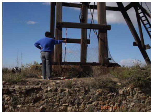
Foto 2.2. Pozo 42-C439. El brocal está desprotegido. Es muy peligroso.
