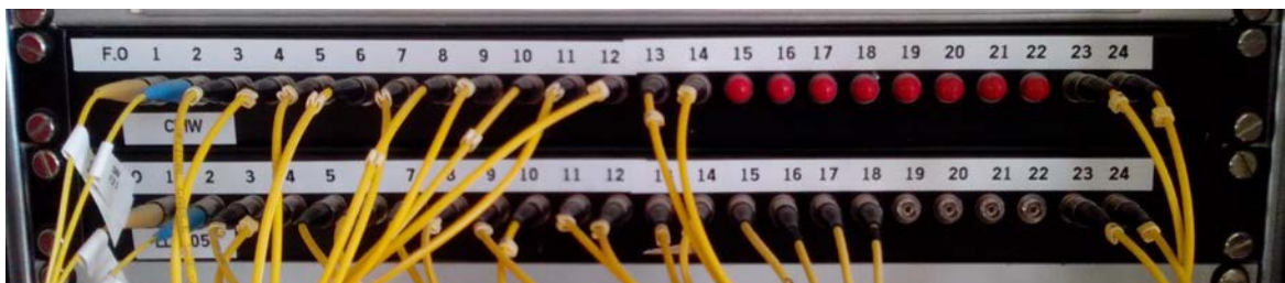
Figura 18 Panel conexionado F.O.
