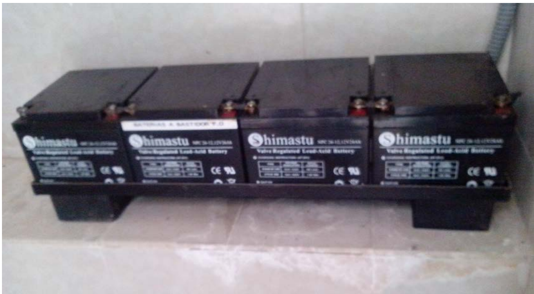
Figura 51 Grupo de baterías
