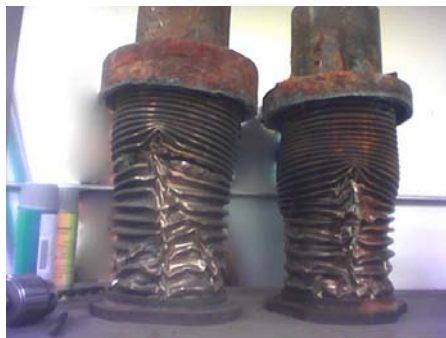
Figura 3.11: Material Destruído por un Golpe de Ariete
