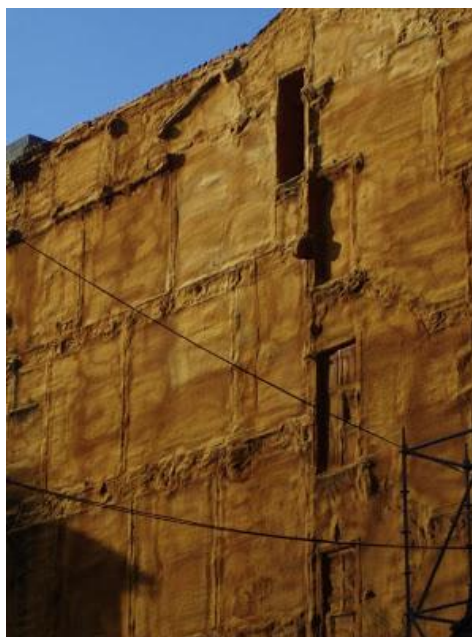
Ilustración 34. Fachada medianera revestida con espuma de poliuretano.
