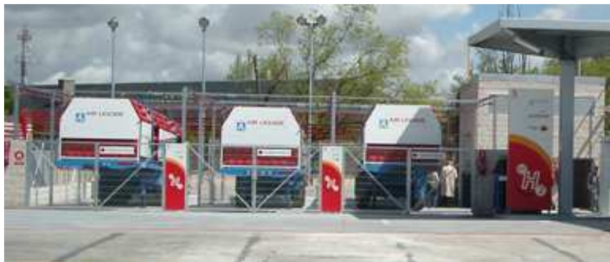
I.14. Almacenamiento de Hidrógeno. 16
