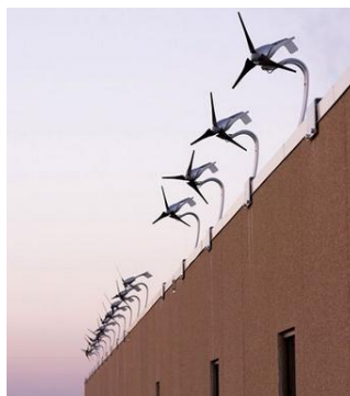
Figura 33 – Instalación Minieólica en edificio
