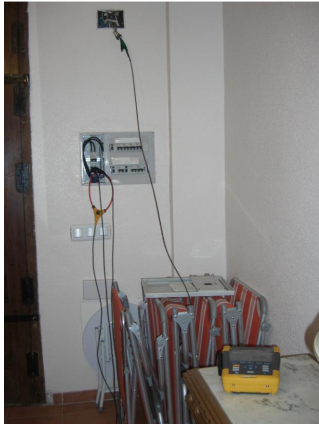
Ilustración 2 Analizador de red instalado
