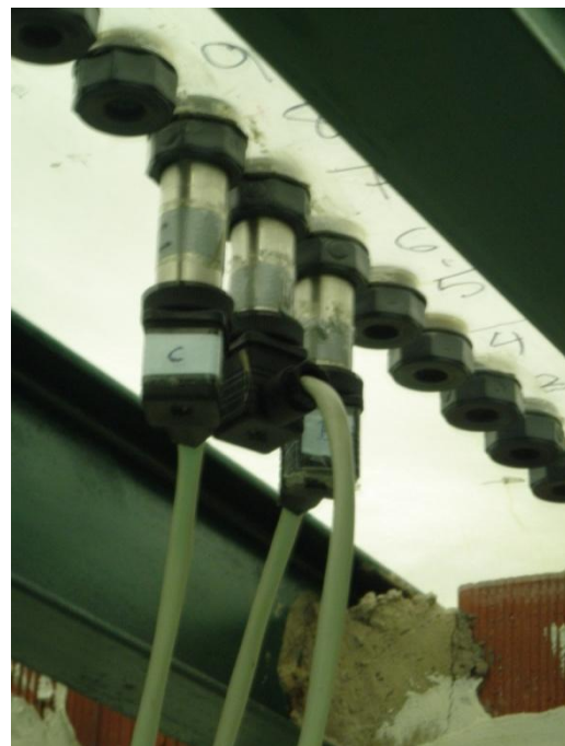
Figura 3.9. Sensores de presión instalados.
