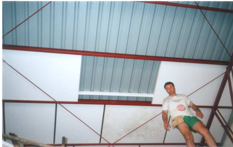
Imagen 5.2.3. Colocación de trozo de plancha de EPS entre las planchas aislantes y la chapa metálica de la cubierta.
