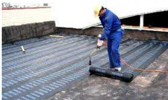
Imagen 5.1.18. Puesta en obra de la lámina asfáltica sobre la base soporte, mediante calentamiento con soplete 1 .
