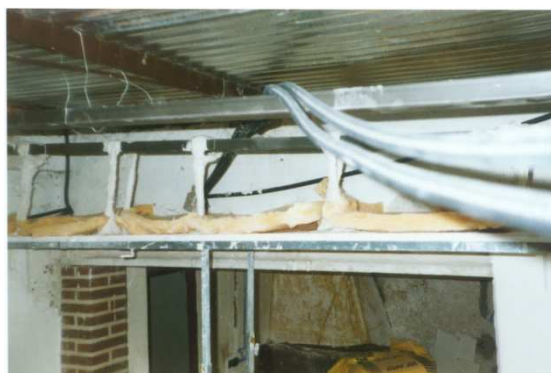
Imagen 5.3.2. Vista de la lana de vidrio, una vez colocada sobre el falso techo.
