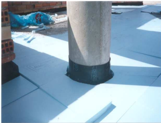
Imagen 5.1.21. Encuentro de las planchas de XPS con pilar de pérgola en cubierta.
