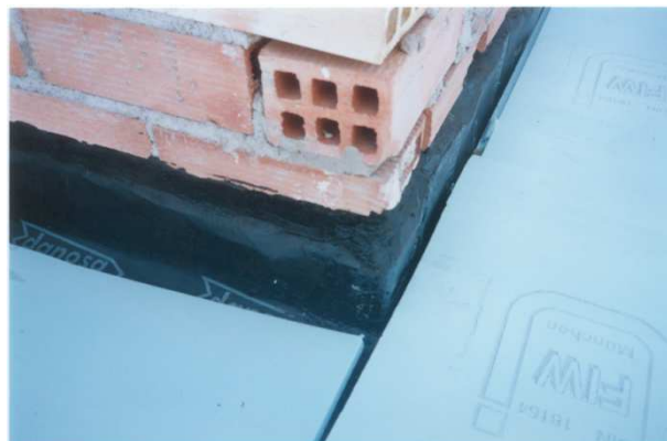
Imagen 5.1.23. Altura de lámina impermeabilizante insuficiente en el encuentro cubierta-antepecho.
