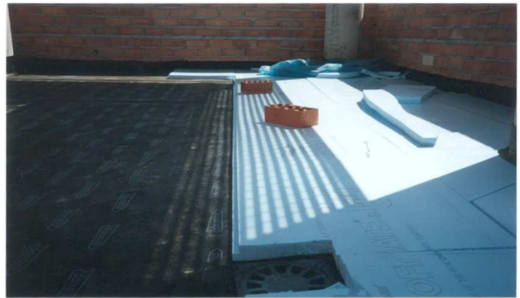
Imagen 5.1.20. Interrupción en la colocación de las planchas de XPS.
