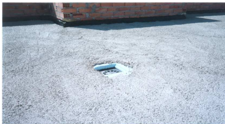
Imagen 5.1.24. Capa de mortero sobre planchas de XPS. Ausencia de geotextil de separación entre ambos.
