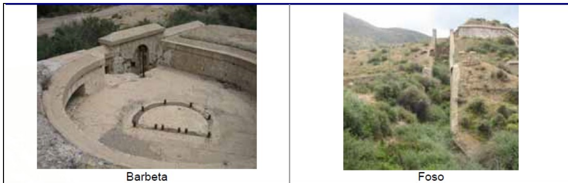
Ilustración 21: Ilustraciones unidad funcional número 13. Fuente: Plan de Gestión batería de Cala Cortina. Ministerio de Medio Ambiente.
