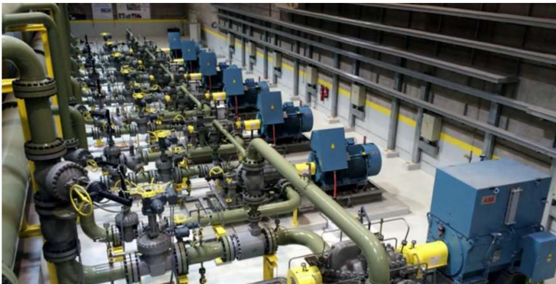
Figura 12. Estación de bombeo. Fuente: Gorona del Viento.
