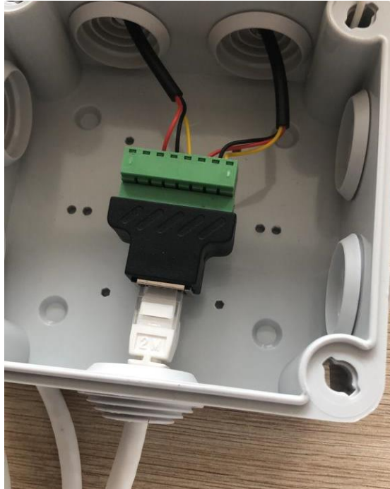
Figura 25: Prueba inicial cableado de los sensores de temperatura (Caja Secundaria).
