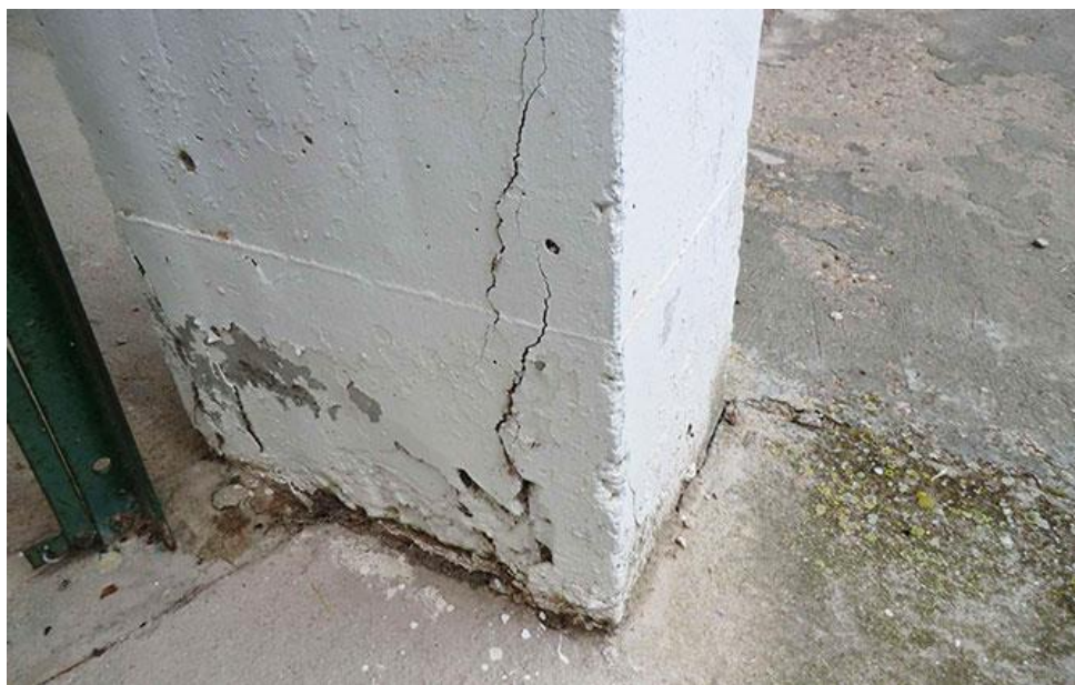
Ilustración 27. Ejemplo de posibles grietas encontradas en elementos estructurales del dique.
