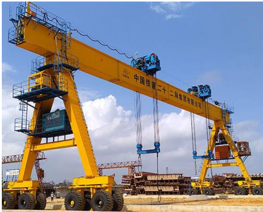
Ilustración 12. Grúa pórtico sobre ruedas
