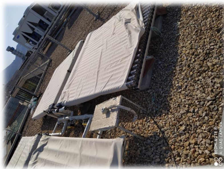
Fig. 8- Imagen real tomada de los colectores en el tejado del ELDI (Edificio de Laboratorios De Investigación).
