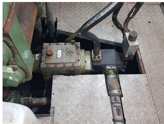
Figura 38. Toma de fuerza hidráulica PTO. Fuente: Elaboración propia
