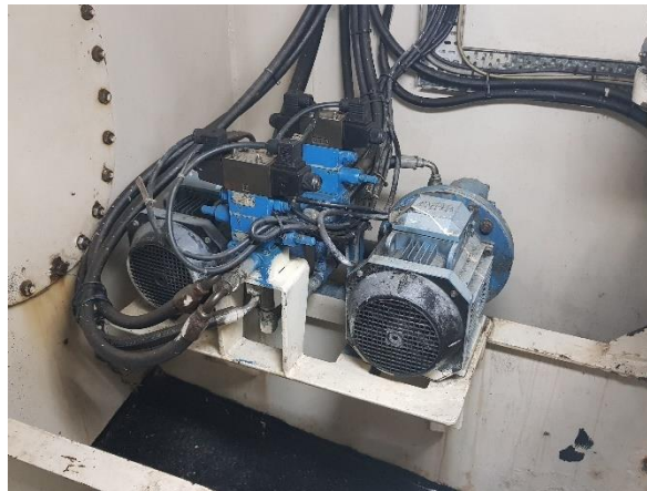
Figura 40. Bombas Hidráulicas que accionan el servomotor. Fuente: Elaboración propia
