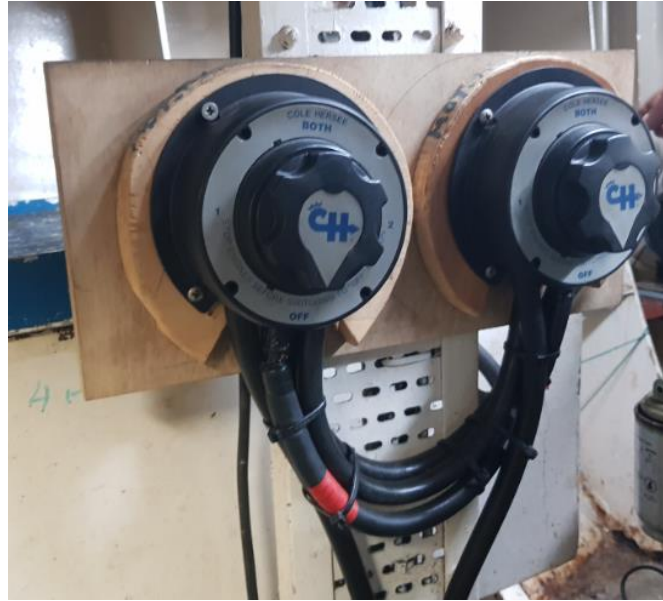
Figura 32. Seleccionador de las baterías de arranque. Fuente: Elaboración propia
