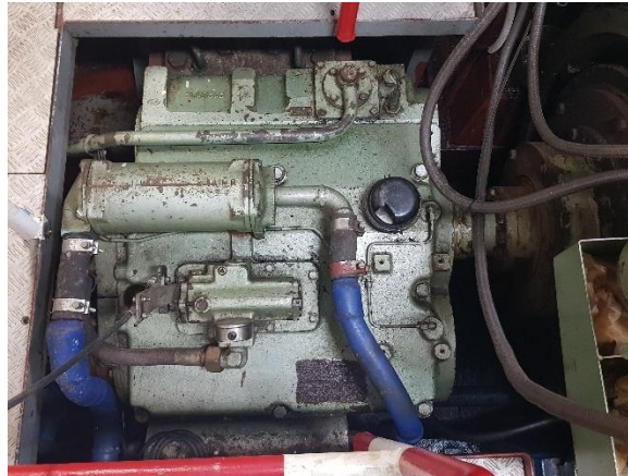
Figura 37. Reductora R360 acoplada al cigüeñal del motor principal. Fuente: Elaboración propia
