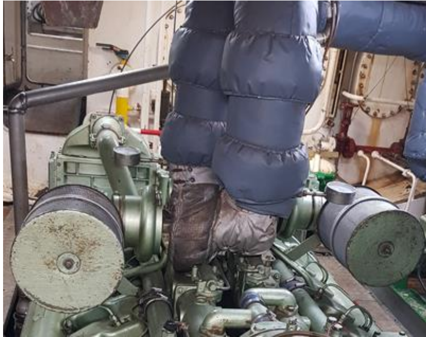
Figura 36. Conductos de exhaustación de los gases de escape. Fuente: Elaboración propia.
