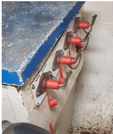
Figura 33. Compartimento de las baterías con el seleccionado manual de encendidas o apagadas. Fuente: Elaboración propia
