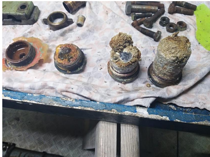
Figura 30. Ánodos de sacrificio para evitar corrosión en los componentes del sistema de refrigeración.
