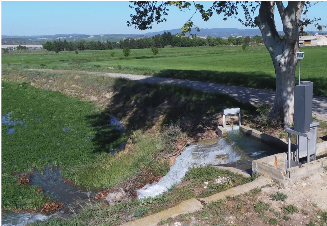
Figura 4. Nodo de 2 compuertas Ziquilink de derivación y 1 compuerta Ziquilink regando finca usando aliviadero.
