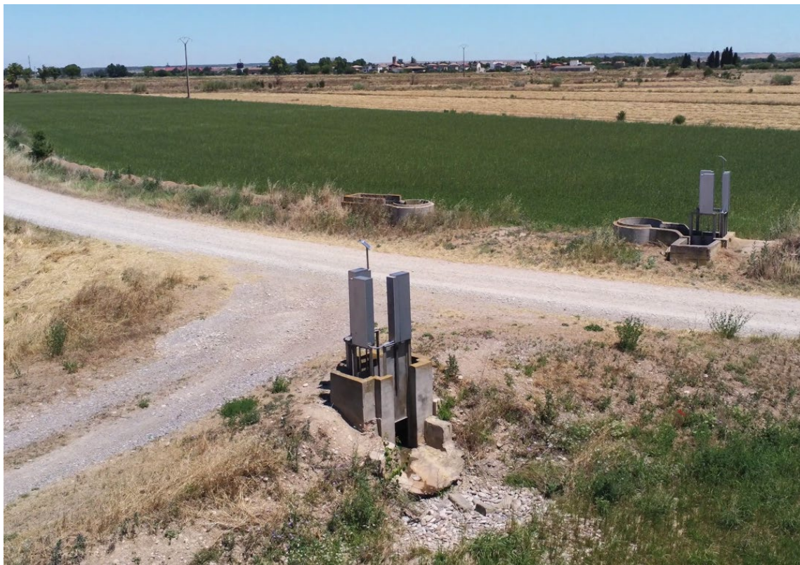
Figura 3. 2 nodos de 3 compuertas Ziquilink en sifones a ambos lados de un camino.
