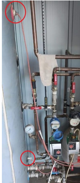
Figura 7: PT1000 instaladas en el depósito
