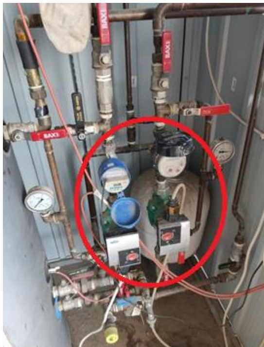
Figura 6: Bombas preinstaladas en la instalación
