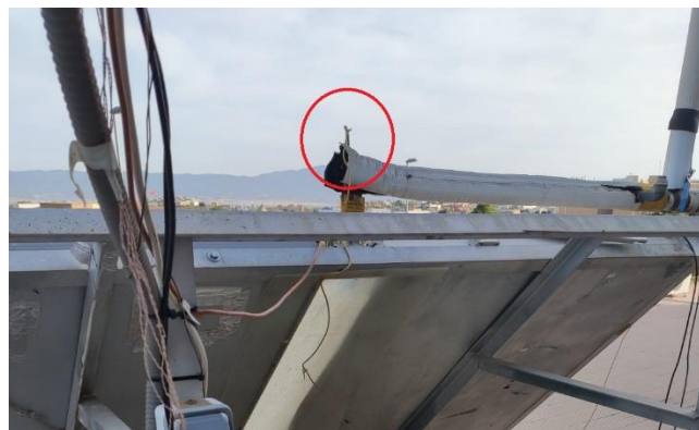
Figura 8: PT1000 instalada en el circuito de tuberías
