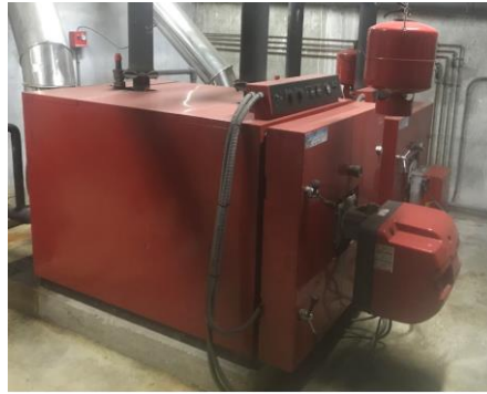
Figura 4. Caldera de gasóleo.
