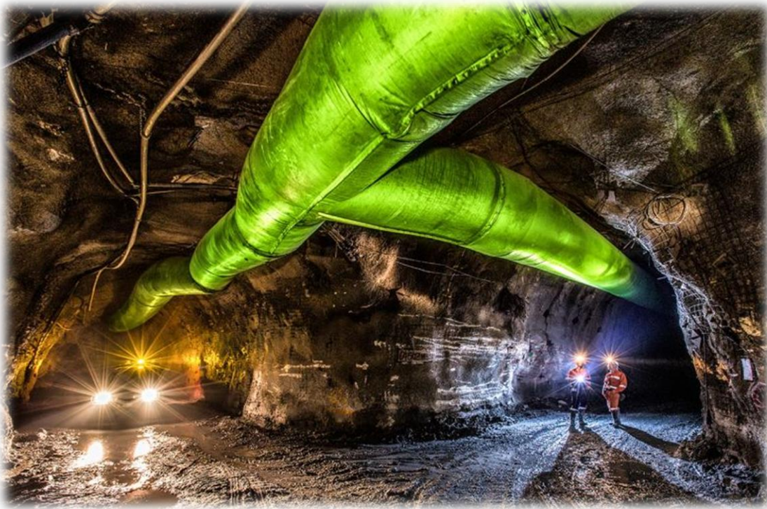
Ilustración 3.4. Conducto de ventilación interior de Fosterville Gold mine, Australia.
