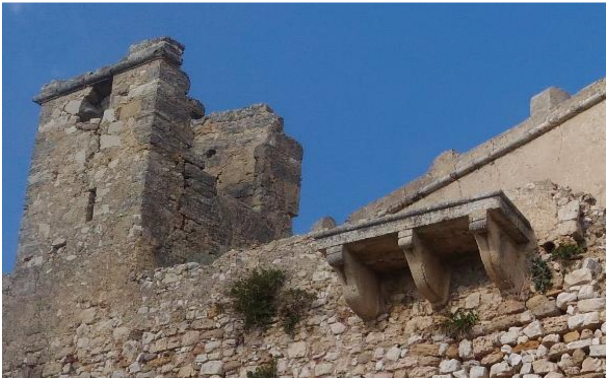
Imagen 16: Restos del balcón en piedra.
