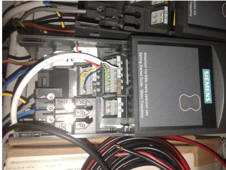
Ilustración 25: Variadores de frecuencia instalados.
