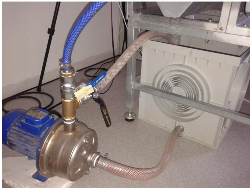
Ilustración 26: Depósito y bomba instalados.
