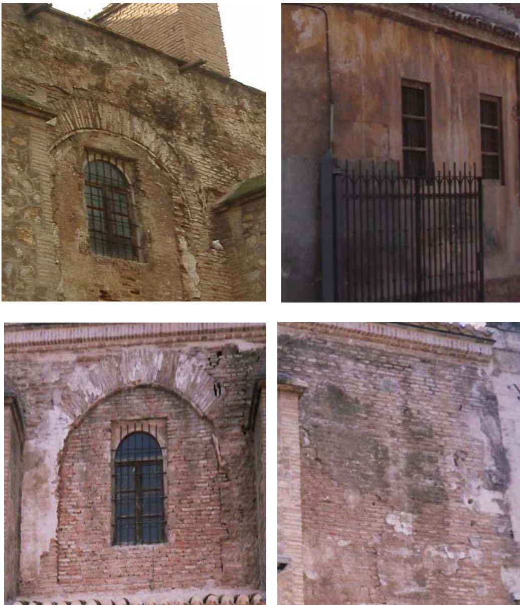
Fig. 14. Costras de suciedad por polvo atmosférico y tráfico rodado. ESTADO ACTUAL.
