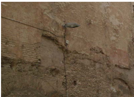
Fig. 19. Desprendimiento en revestimiento.
