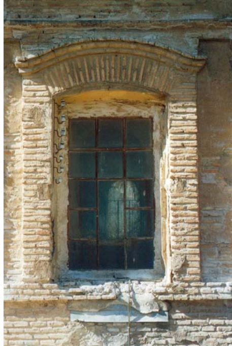
Fig. 23. El ladrillo erosionado es una de las constantes de la fachada Norte de la iglesia, perdiendo casi sus dimensiones y forma original, todo ello debido a un proceso lento, de muchos años.
