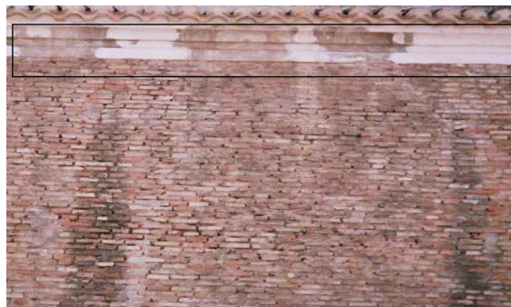
Fig. 17. Los relieves de las cornisas favorecen el ensuciamiento de la fachada.
