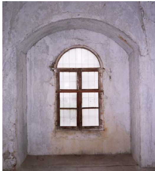
Fig. 21. Decoloraciones claras en el interior de la iglesia.
