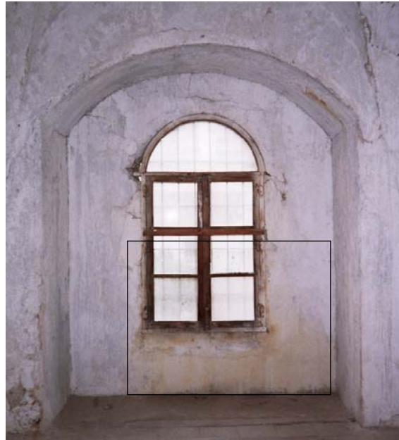
Fig.11. Oxidación electroquímica por infiltración del agua de lluvia de los elementos metálicos de la ventana en el interior de la fachada Norte de la iglesia.
