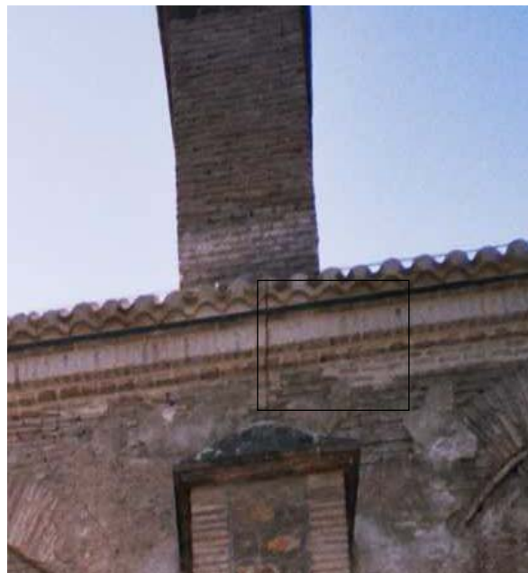
Fig. 9. Fisura causada por la carga vertical del contrafuerte. Por compresión simple.
