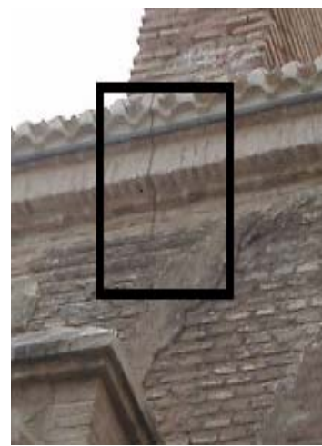
Fig. 4. Fisuras por cargas centradas.
