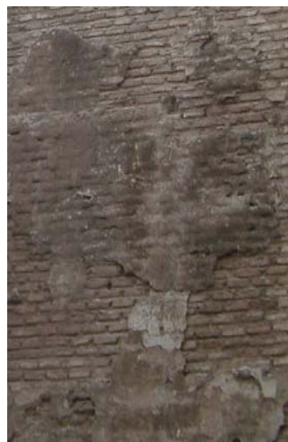
Fig. 3. Desprendimiento del revestimiento.
