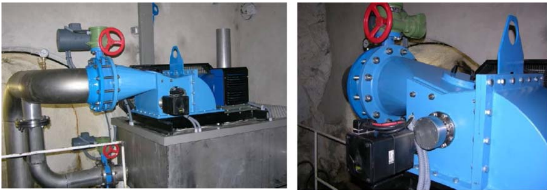
Figura 26: Detalle grupo turbina- generador.
