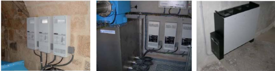
Figura 30: Reguladores de carga (derecha) y disipador por aire (izquierda)
