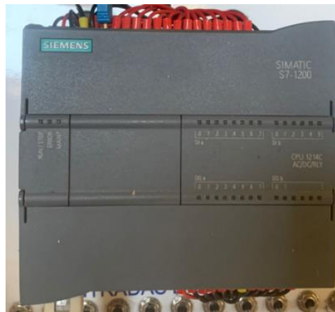
Figura 13. PLC Siemens S7 1200.
