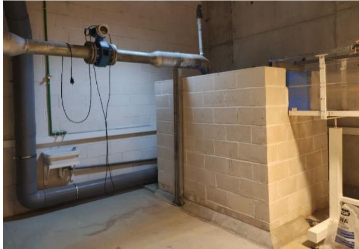
Figura 4. Tubería de acero galvanizado y exterior de arqueta.
