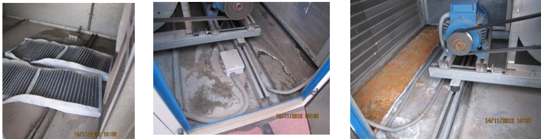
Figura 2, 3 y 4: Estado de la Unidades de Tratamiento de Aire.
