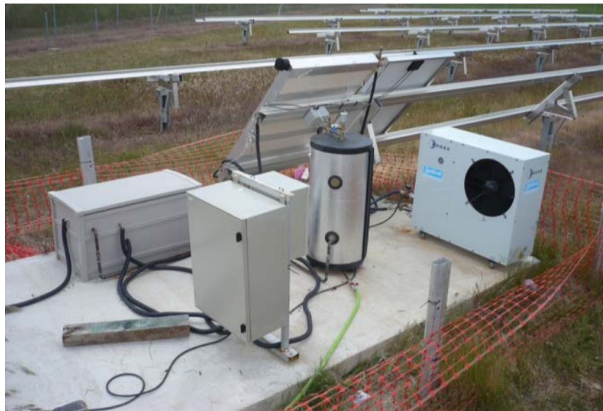
Figura 6: Instalación de ensayo de paneles PVT.
