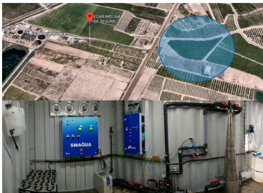
Figura 1. Instalación de ozonización a pie de parcela. Localización y detalle de la instalación.
