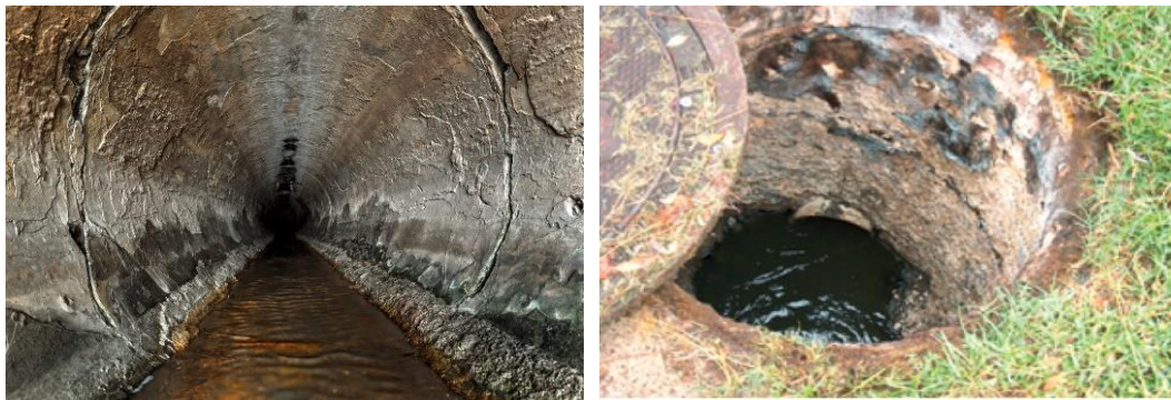
Figura 3. Ejemplos de corrosión en elementos de saneamiento por acción del ácido sulfúrico (Universidad de Queensland; adforensics.wordpress.com)
