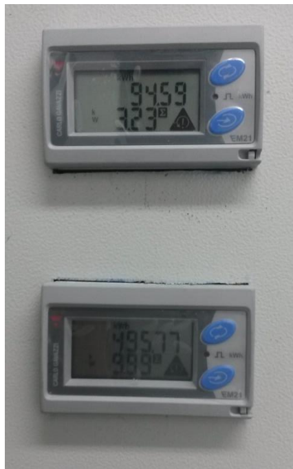
Figura 59. Medidores de consumo eléctrico conectados con la centralita, el primero específico de la deshumectadora, el segundo corresponde al consumo global
