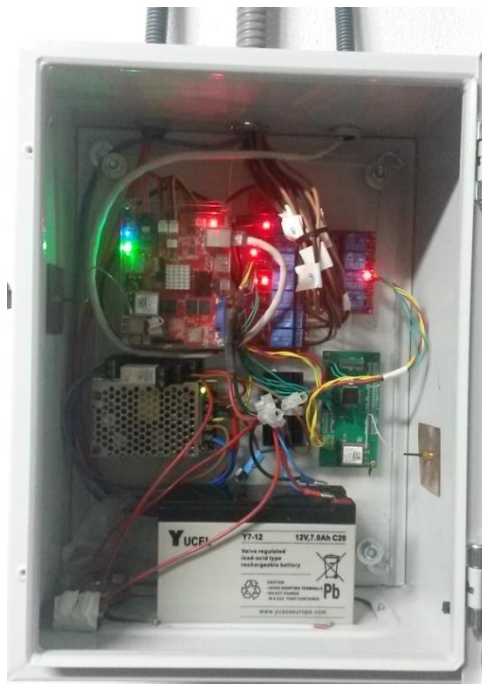
Figura 57. Centralita de control con batería en su armario
