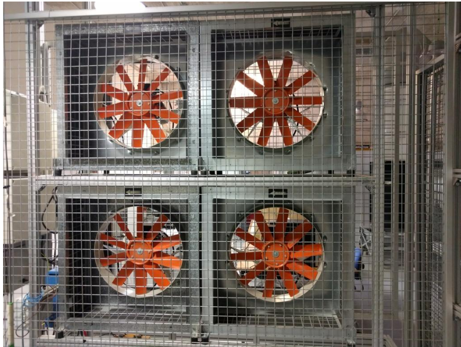
Figura 75: Rejilla colocada frente a ventiladores
