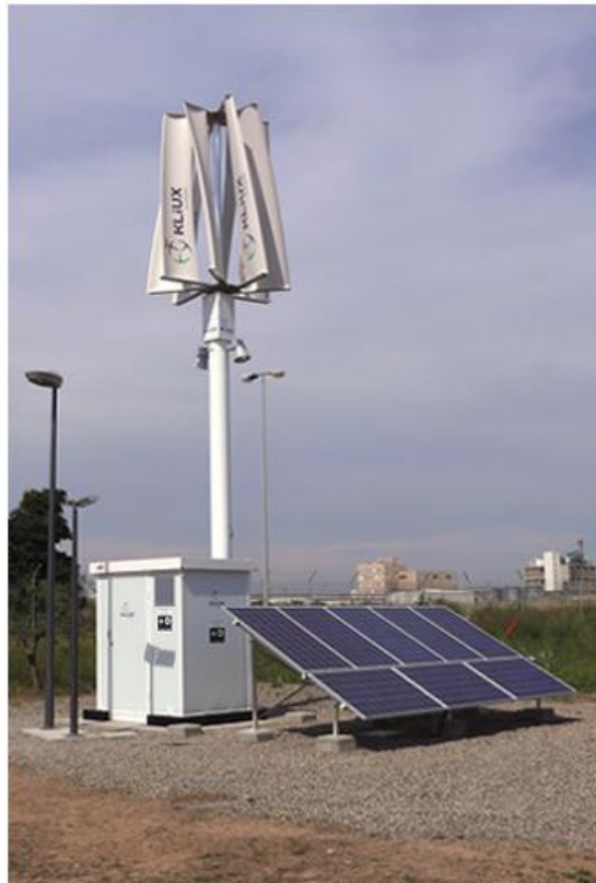
Figura 21: Sistema híbrido de la empresa Kliux Energies instalado en la planta de Bayer MS en Tarragona
