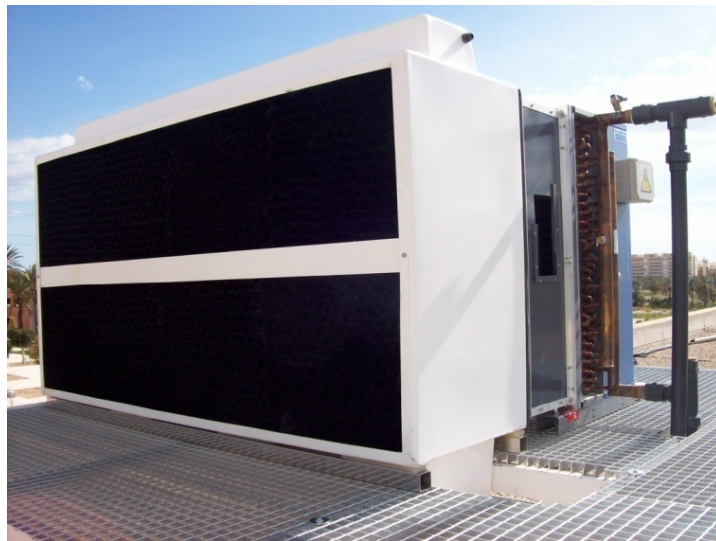
Fig. 3. Prototipo. Aero-refrigerador con pre-enfriamiento adiabático
