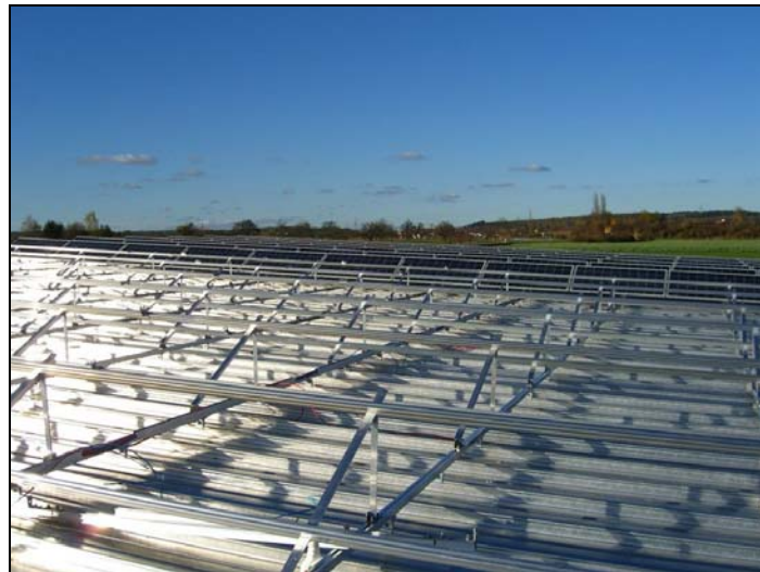
Figura 12.1.- Estructura soporte de los módulos sobre la cubierta.
