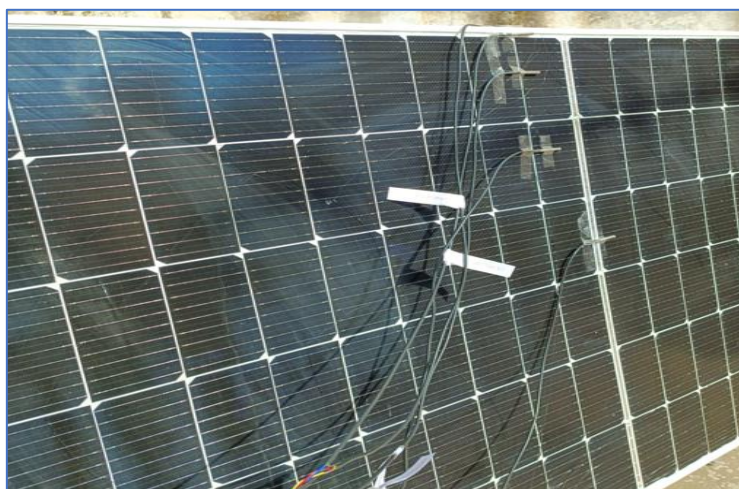
Figura 60. Medición de temperaturas caso 2
