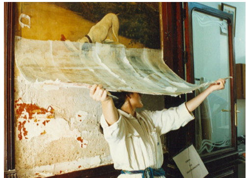
Figura 11. Proceso de despegue del lienzo de la pared, para proceder al picado, saneado y enlucido de los muros.
